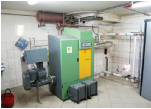
fol. Jacek Michalski Kociołownia w budynku Wiejskiego Ośrodka Zdrowia w Budziszawie Kościelnym opalana peletem
