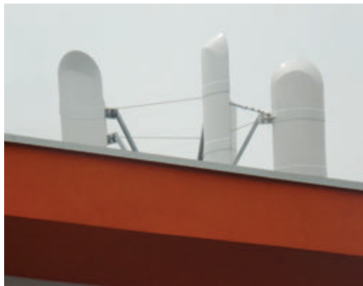
fot. Ewa Kwapich Turbina o pionowej osi obrotu na budynku Centrum Transferu Technologii Nuvarro w Posadzie
