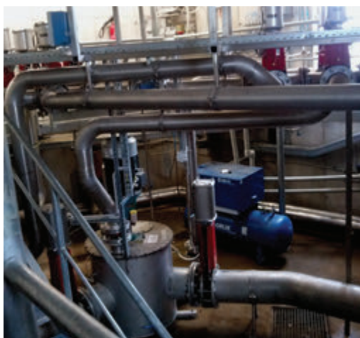
fol. Monika Urbańska Wnętrze przepompowni biogazowni w Psarach
