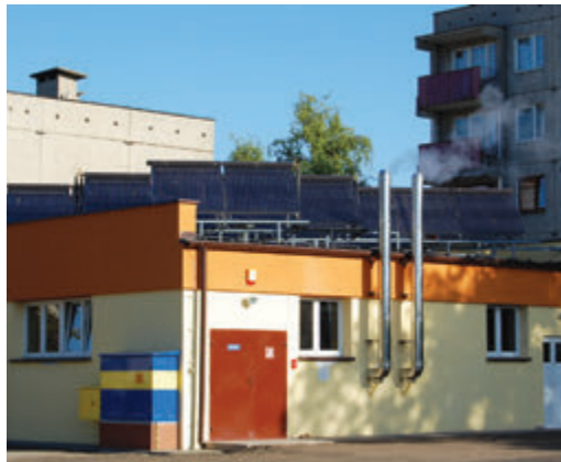
fol. Jacek Michalski Kotłownia w Kleczewie z próżniowymi kolektorami
