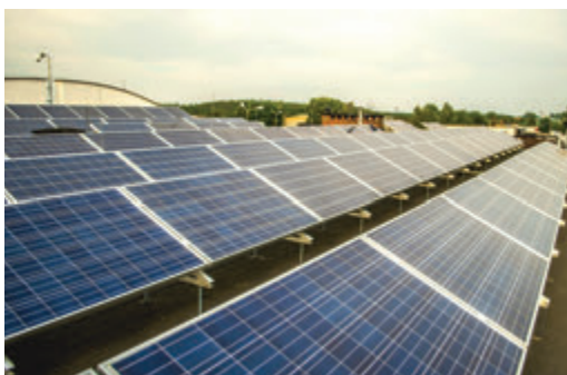
fol. Instalacja fotowoltaiczna na budynku WORD w Koninie
