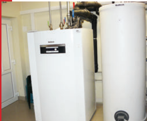
fot. Ewa Kwapich Pompa ciepła w prywatnym domu w Lubomysłu
