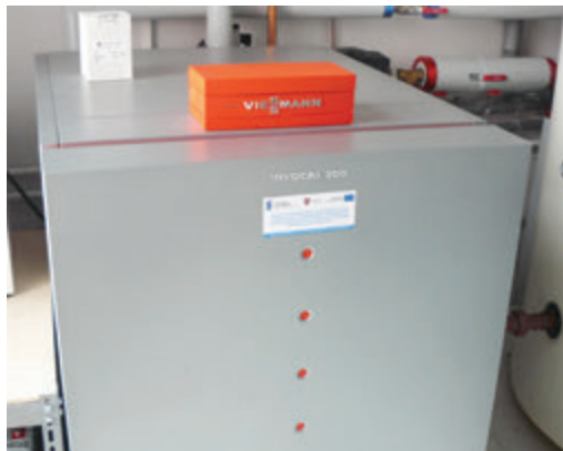
fot. Ewa Kwapich Pompa ciepła w Centrum Transferu Technologii Nuvarro w Posadzje
