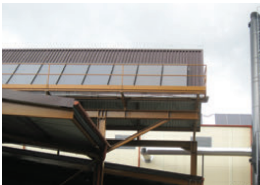
fol. Kolektory słoneczne na dachu kotłowni szpitala specjalistycznego w Pile
