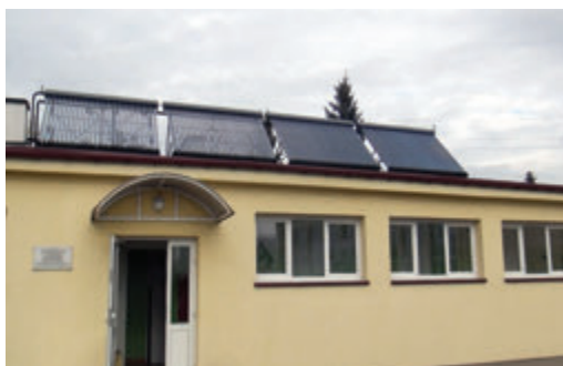
fol. Jacek Strykowski Kolektory słoneczne na budynku szatni OSiR w Kleczewie
